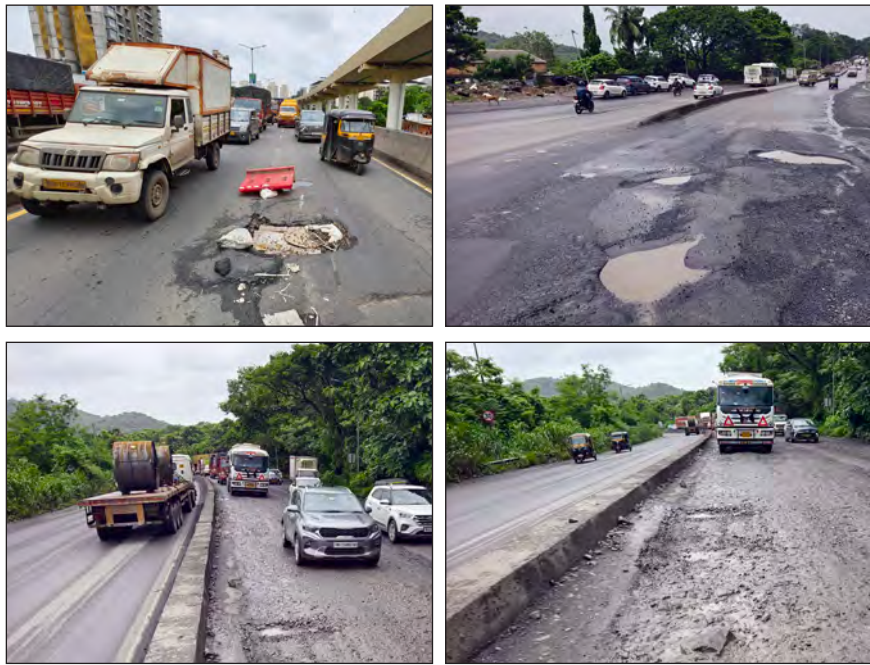
ठाणे, घोडबंदर रस्त्यावरील वाघबीळ उड्डाण पुलावर खड्डे तसेच गायमुख चौपाटी पासून ठाणे कडे येणारा रस्ता वर खड्डे पडले असल्याचे दिसून आले. (छाया - मनोज सिंह )
